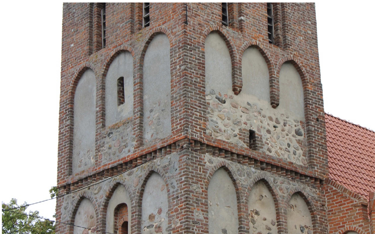
Fot.7. Kruszyny, kościół pw. św. Mikołaja. Trzon wieży od strony południowo-zachodniej. Na zdjęciu widoczne zachowane zaprawy historyczne w dolnej części nisz i wtórne cementowe w górnej części.
