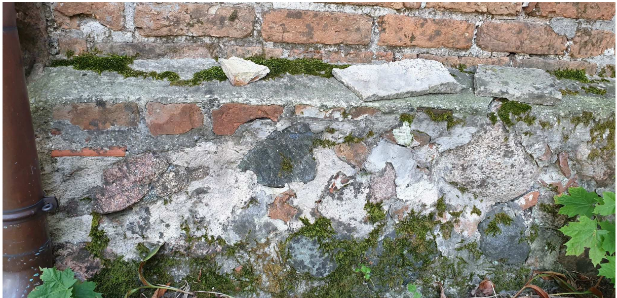
Fot.6. Kruszyny, kościół pw. św. Mikołaja. Widok ogólny na wątek kamienny (kaplica). Na zdjęciu widoczny fragment wątku uszczelnionego wtórnie szarą zaprawą cementową.
