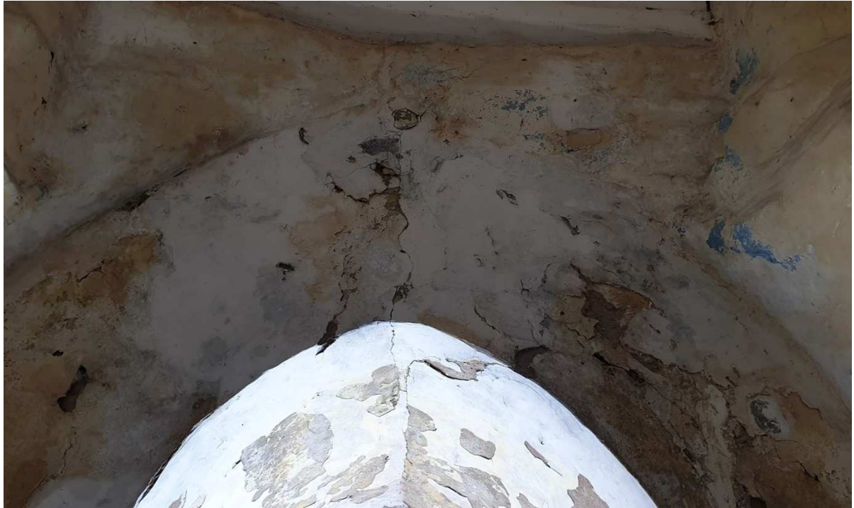
Fot.15. Kruszyny, kościół pw. św. Mikołaja. Spękania i zawilgocenie w nadprożu wejścia kruchty związane jest z przenikaniem wody opadowej spływającej po trzonie wieży w głąb muru i jej utrudnionym odsychaniem w wyniku uszczelnienia wątku zaprawami cementowymi.
