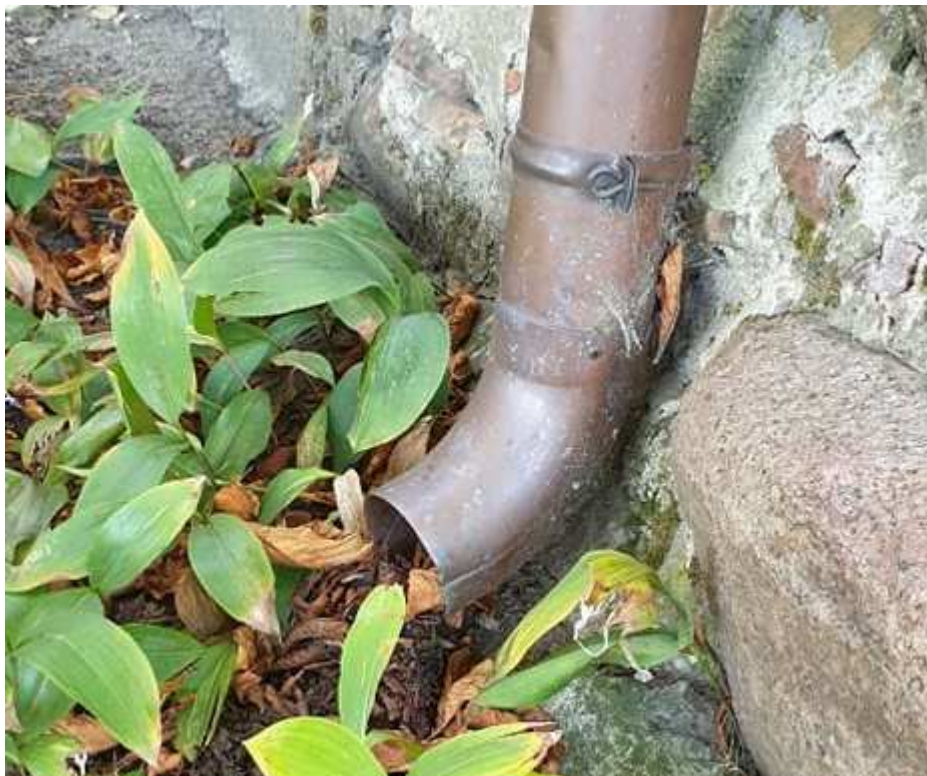
Fot.12. Kruszyny, kościół pw. św. Mikołaja. Sposób odprowadzenia wody opadowej. Odpływy rur spustowych znajdują się zbyt blisko elewacji.
