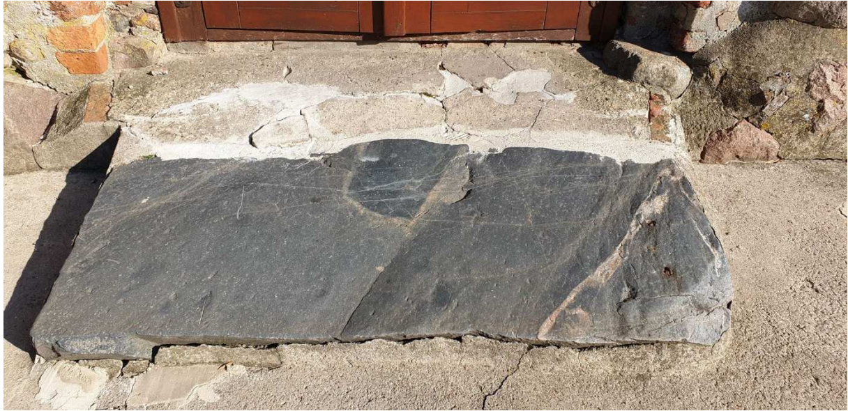
Fot.9. Kruszyny, kościół pw. św. Mikołaja. Szczyt elewacji wschodniej. Bazaltowa stopnica kruchty zachodniej.
