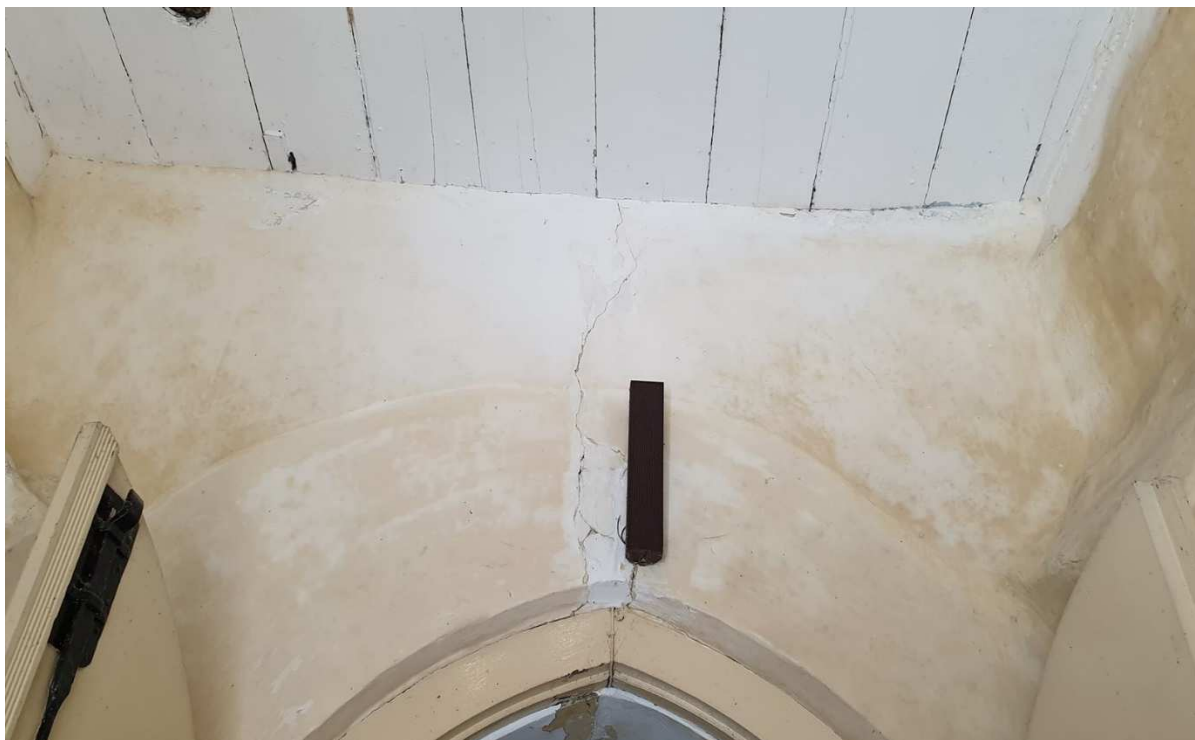
Fot.14. Kruszyny, kościół pw. św. Mikołaja. Spękania widoczne na wewnętrznych ścianach kruchty zachodniej.
