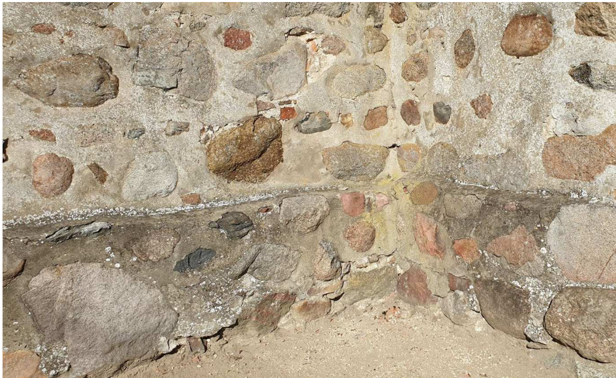
Fot.11. Kruszyny, kościół pw. św. Mikołaja. Fragment wątku kamiennego wieży. Wtórna, cementowa spoina jest w wielu miejscach spękana i odspojona.
