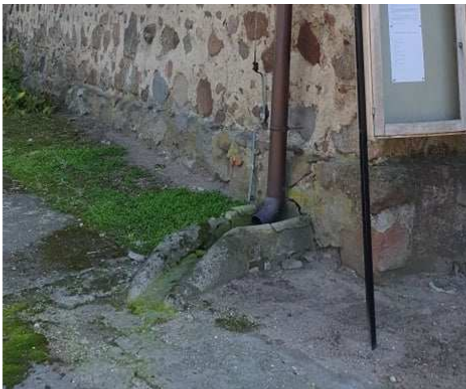
Fot.13. Kruszyny, kościół pw. św. Mikołaja. Sposób odprowadzenia wody opadowej. Część elewacji-wieża jest nadal otoczona betonową opaską.
