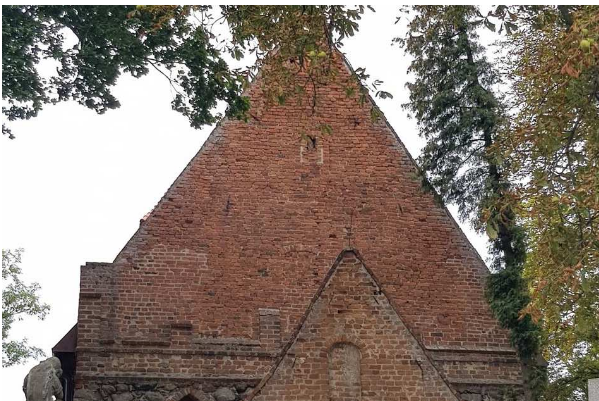
Fot.8. Kruszyny, kościół pw. św. Mikołaja. Szczyt elewacji wschodniej. Na zdjęciu widoczny chaotyczny, słabo zdefiniowany watek ściany szczytowej. Cegła jest powierzchnio wypłukana. Lokalnie, po stronie południowej widoczne są „świeże” naprawy.
