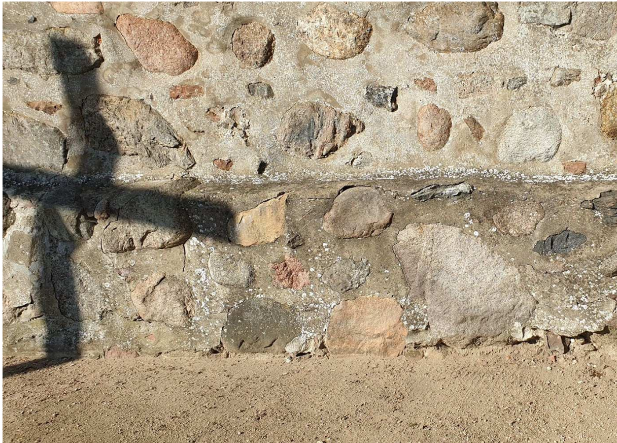
Fot.10. Kruszyny, kościół pw. św. Mikołaja. Fragment wątku kamiennego wieży. Na zdjęciu widoczna wtórna, cementowa spoina oraz liczne nawarstwienia biologiczne w postaci kolonii porostów.
